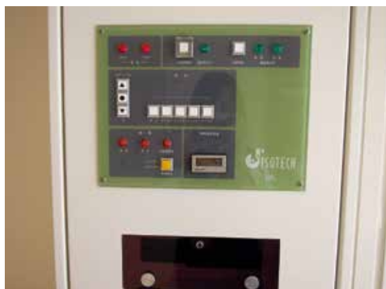
換気や照明の制御盤
